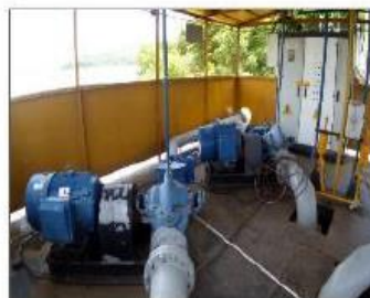
Foto 50. Equipos de bombeo – Barcaza Flotante
