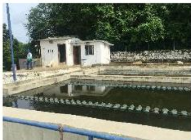
Foto 51. Módulos de Filtración PTAP
