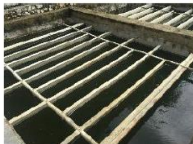
Foto 52. Módulos de Floculación PTAP
