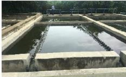
Foto 53. Módulos de Filtración PTAP
